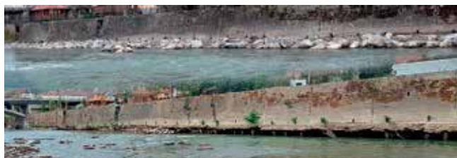
Slika 3: Primerjava med erodirano podporo škarp po avgustovskih poplavah (spodaj) in izgled po sanaciji podpore in brežine (zgoraj) (foto: G. Berčič).
