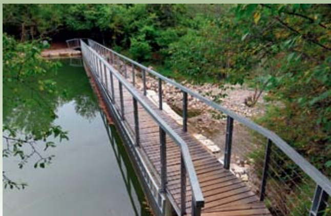
Leta 2019 so končali dela na novi betonski pregradi in po njej speljali krožno sprehajalno ter učno Orlovo pot.
