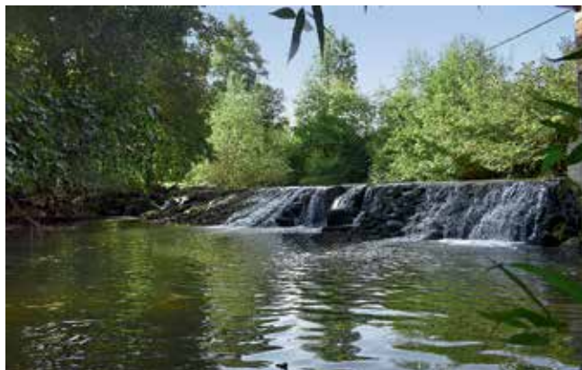
Slika 1: Prag na Težki vodi - poškodba leži v levem kotu slike pod drevesom. Na sredini je odprtina za izpust vode.
