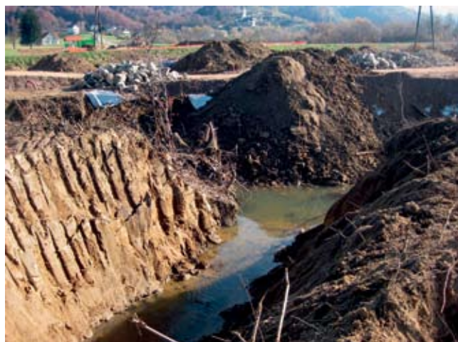
Iz gradbeno razdejanega starega in novega korita v prepozno naročenem intervencijskem odlovu rib in drugih vodnih organizmov ni bilo mogoče več rešiti.
