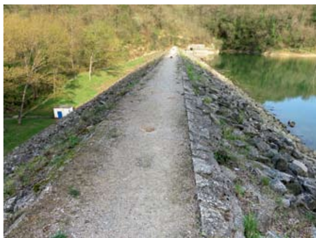
Krona pregrade z vidnimi poškodbami pohodne površine (in reperjev) ter zaščitnih tlakov.
