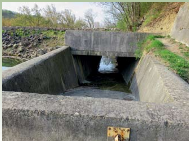
Betonski varnostni preliv skozi telo pregrade.
