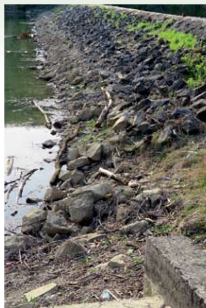
Poškodbe v zaščitnem tlaku in naplavine na vodni strani pregrade.
