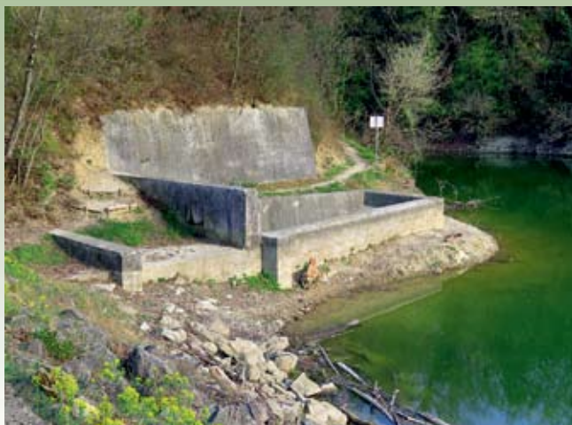
Betonski varnostni preliv skozi telo pregrade.
