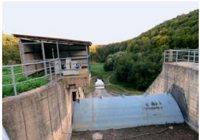
Prelivni objekt s hidromehansko opremo
