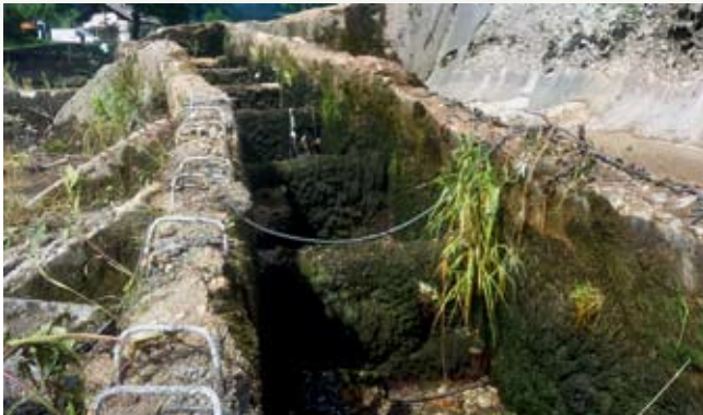
Ribja steza na jezui v Goričanah pred obnovo. Vidna je obraščenost z mahom, kar zanika trditve, da se ribe poškodujejo pri prehodu prek betonskih kaskad.
