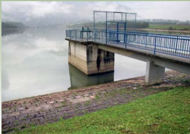
Iztočni objekt s hidromehansko opremo
