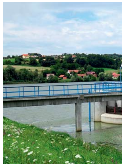
Iztočni objekt s hidromehansko opremo za regulacijo pretokov vode.
