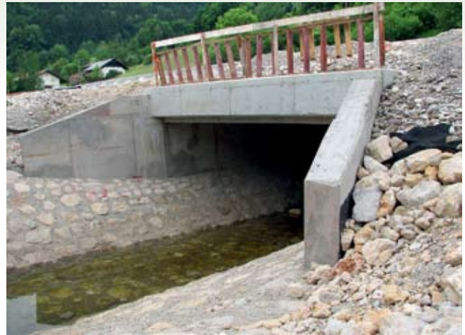
S pokritim kanaliziranjem pritoka akumulacijskega bazena hidroelektrarne je bilo trajno uničeno drstišče oligoreofilnih rib.
