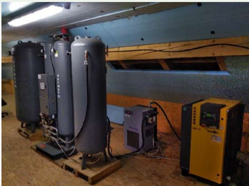
Slika 1: Generator kisika PSA, recikulacija Dvor (2019)
