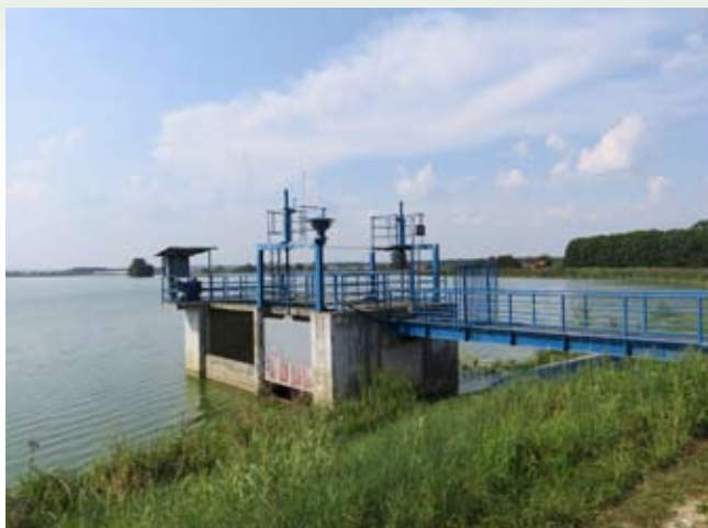
Regulacijski objekt z hidromehansko opremo.
